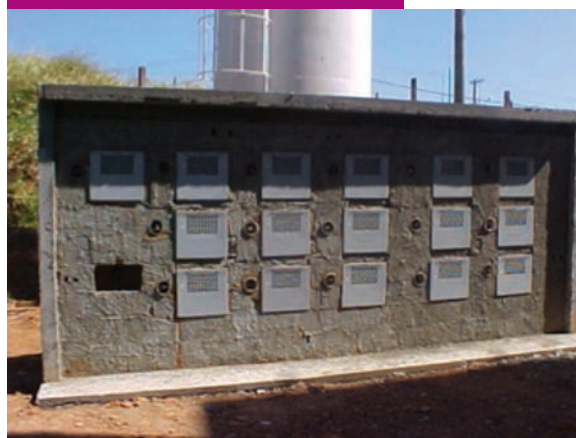
Figura 5 – Abrigos de proteção para o medidor (Sanasa, Campinas)
