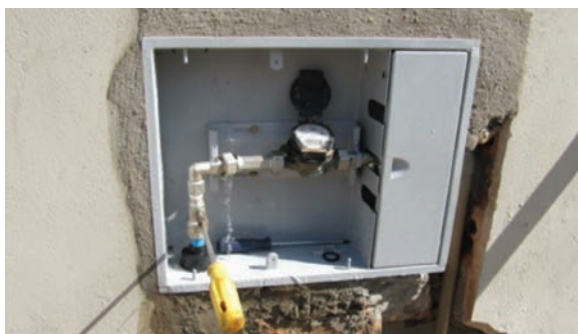
Figura 4 – Detalhes do abrigo de proteção para o medidor utilizado pela Sabesp
