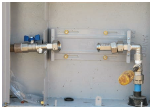
Detalhe do acabamento para o tubo camisa, no interior do abrigo de proteção (Sabesp)
