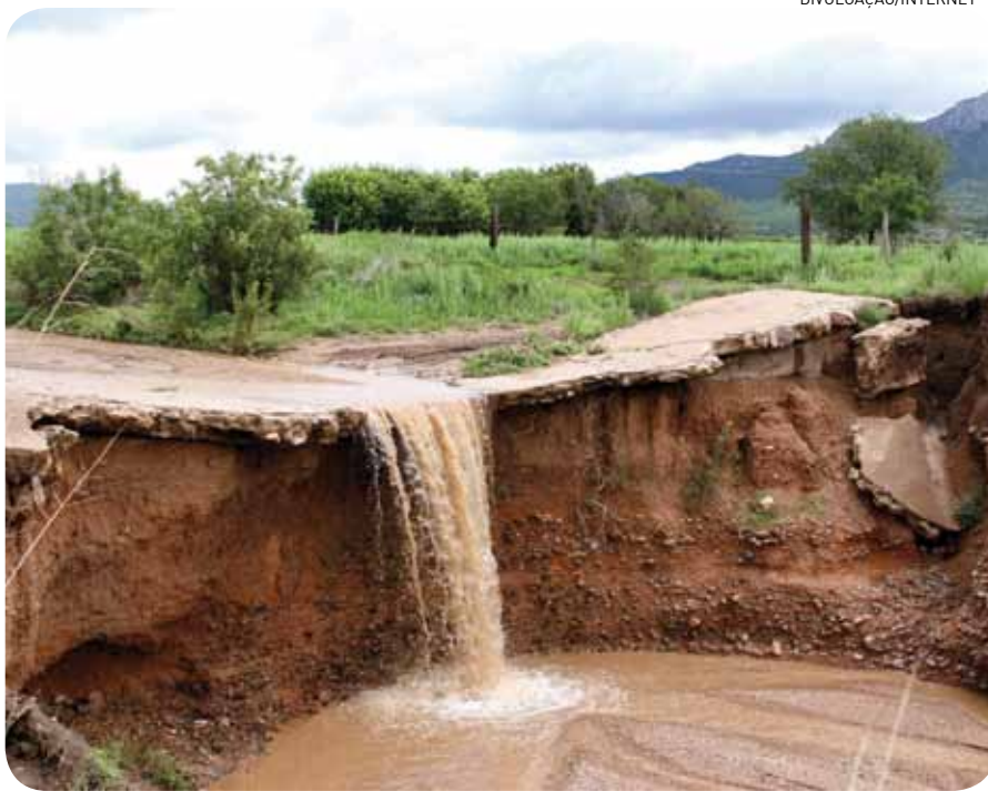
Terremoto também destruiu estradas no México
