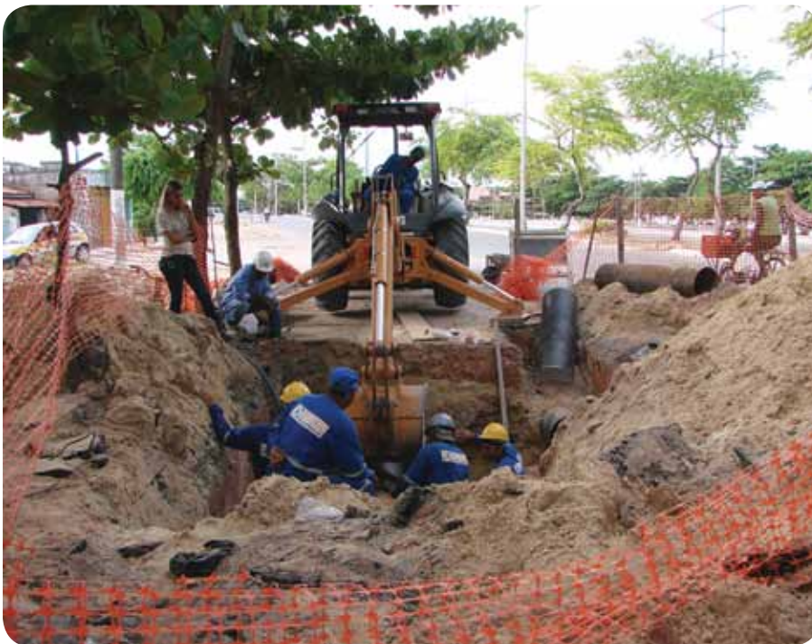
Instalação de anéis de distribuição de água faz a interligação da rede nova com a antiga
