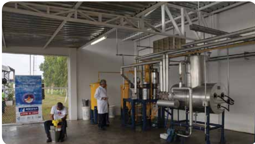
Visão parcial da usina de biodiesel da Agespisa
